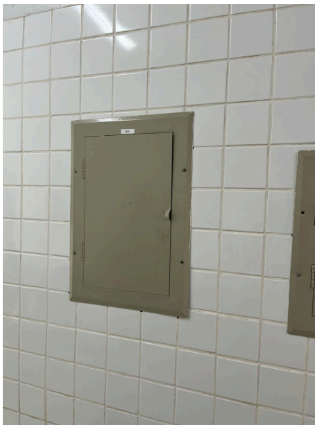
Figura 17: Vista de quadro de energia.
