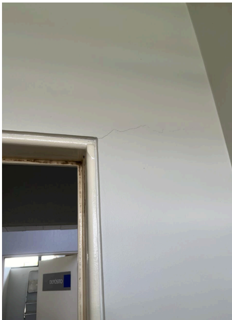
Figura 15: Vista de parede fissurada.
