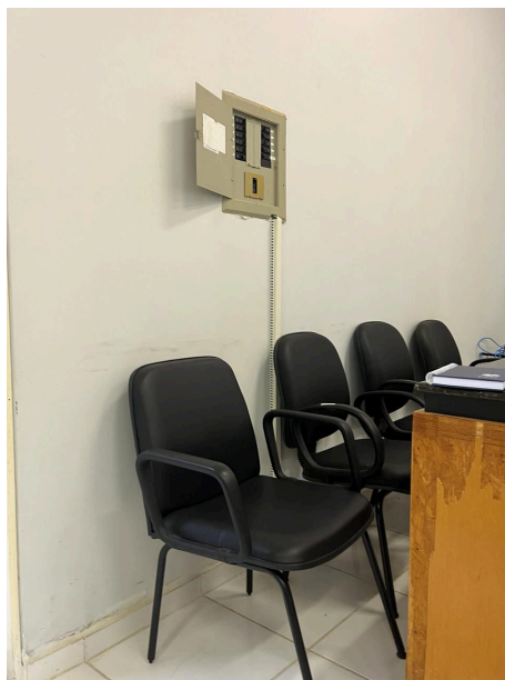
Figura 71: Vista da caixa de energia.
