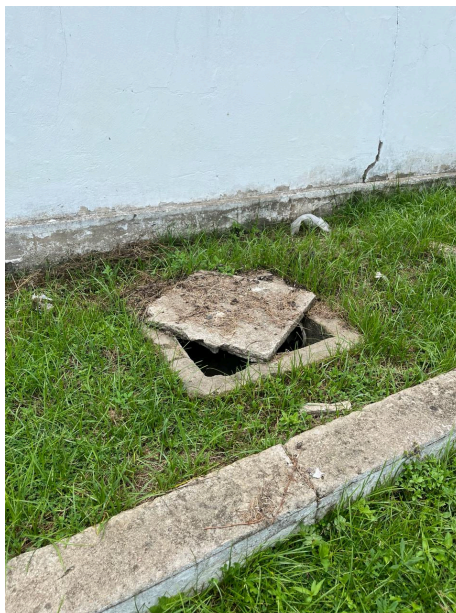
Figura 38: Vista de caixa de passagem.
