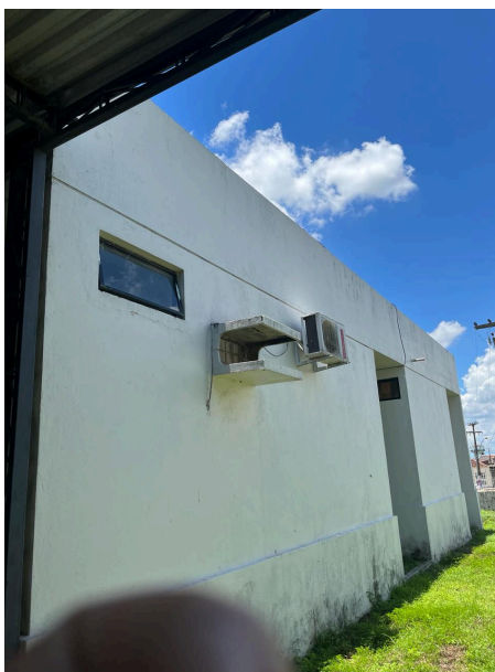
Figuras 07 e 08: Vistas de ar condicionados.
