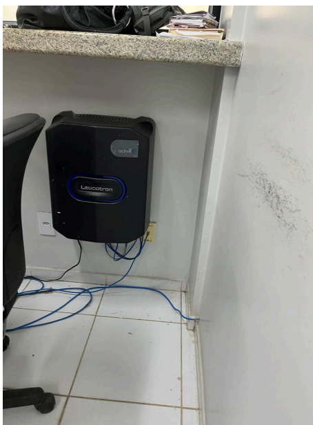
Figura 63: Vista da central técnica.
