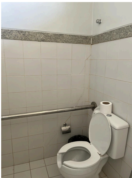
Figura 32: Vista de parede fissurada.
