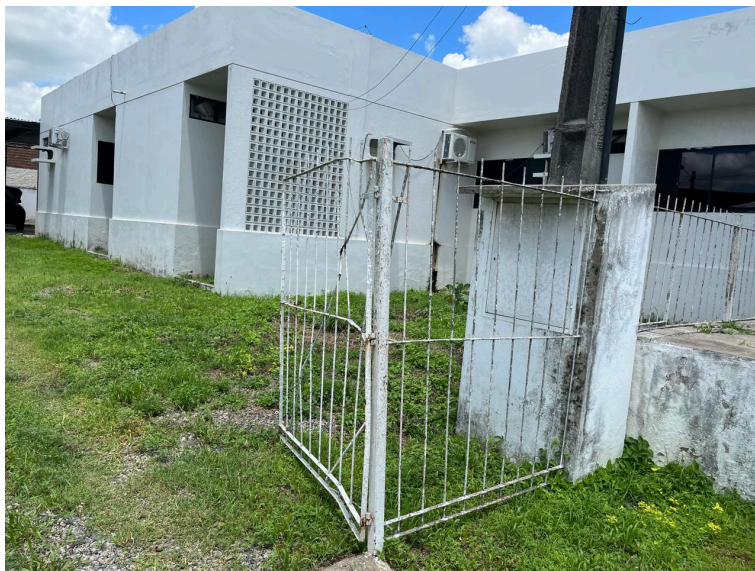
Figura 50: Vista do gradil danificado.
