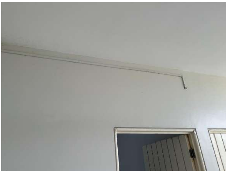
Figuras 02 e 03: Vistas de interruptores e canaletas.
