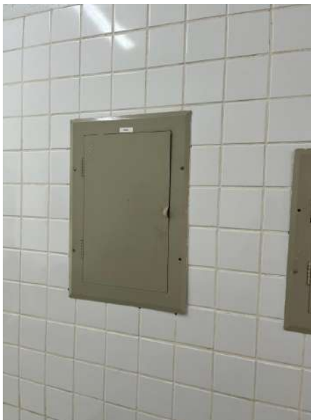
Figura 17: Vista de quadro de energia.
