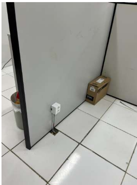
Figura 12: Vista do piso danificado.
