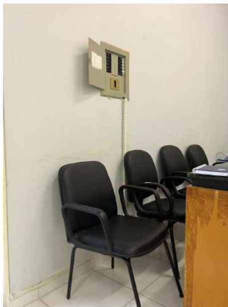
Figura 71: Vista da caixa de energia.
