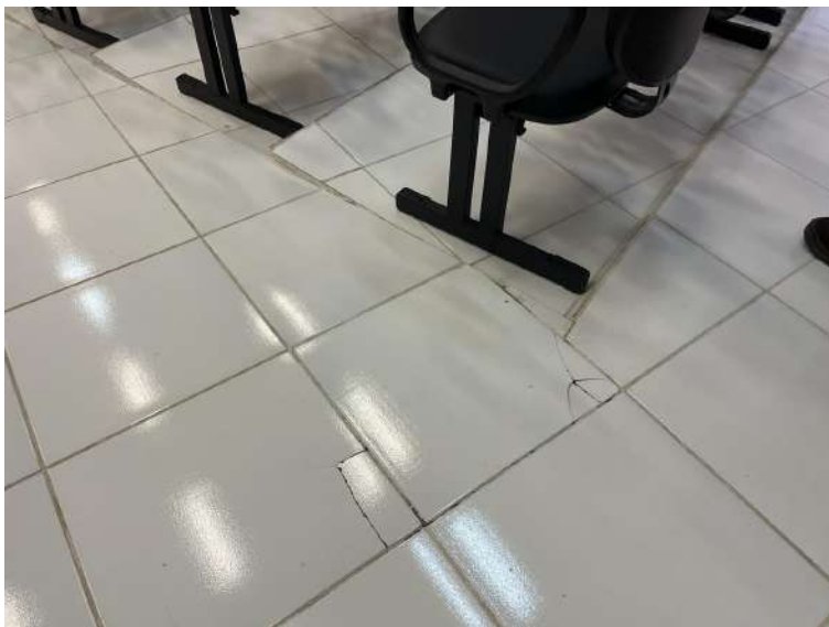
Figura 70: Vista do piso danificado.
