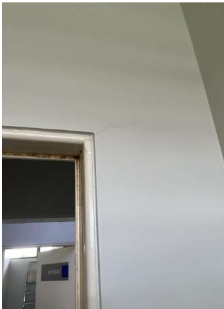
Figura 15: Vista de parede fissurada.
