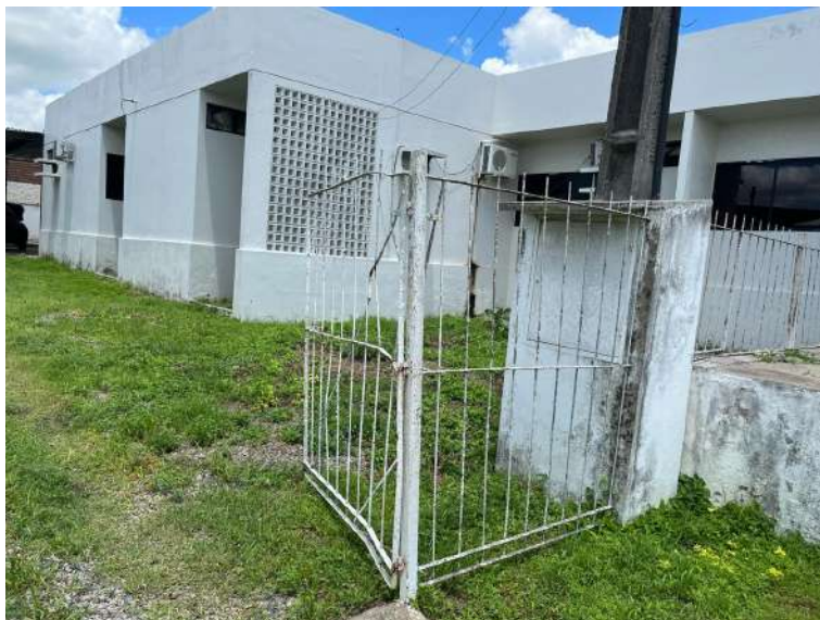
Figura 50: Vista do gradil danificado.
