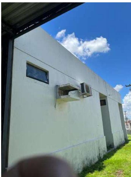
Figuras 07 e 08: Vistas de ar condicionados.
