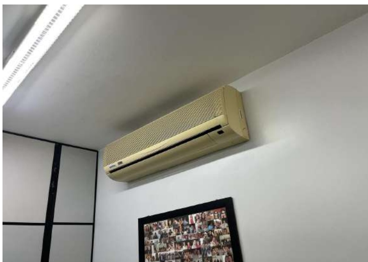
Figura 64: Vista do ar condicionado queimado.
