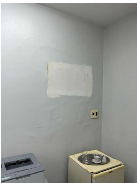
Figura 01: Vista de parede infiltrada.
