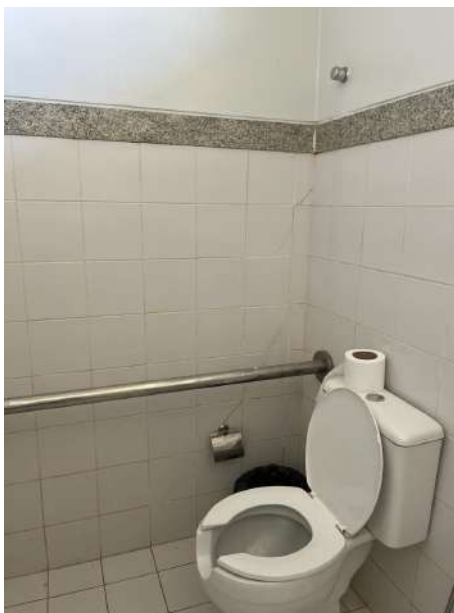
Figura 32: Vista de parede fissurada.
